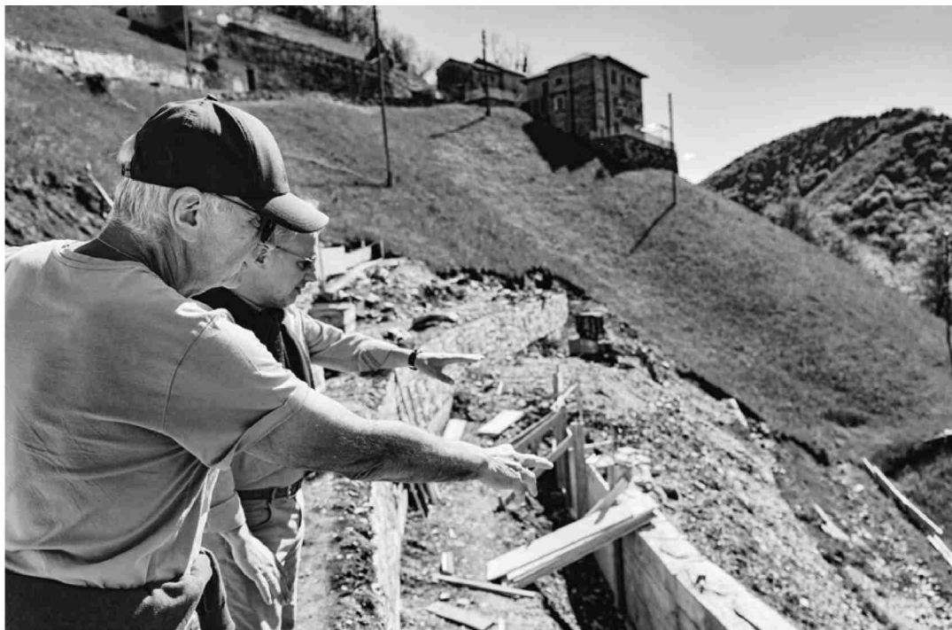
Aurelio Casanova, ehrenamtlicher Berghilfe-Experte, besichtigt mit Claudio Zanini die Baustelle beim Bed & Breakfast.
